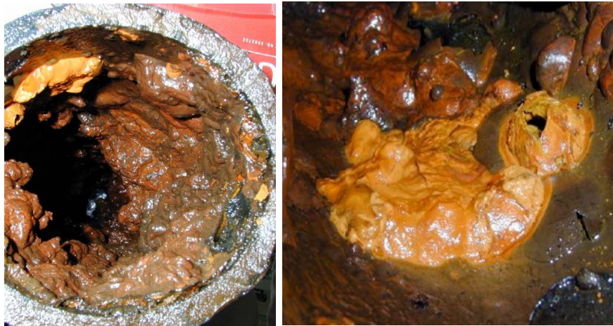
Abb.4: Innenansicht eines Trinkwasserrohrs. Mit freundlicher Genehmigung von Prof. Flemming IWW Mülheim Ruhr Universität 2012.
