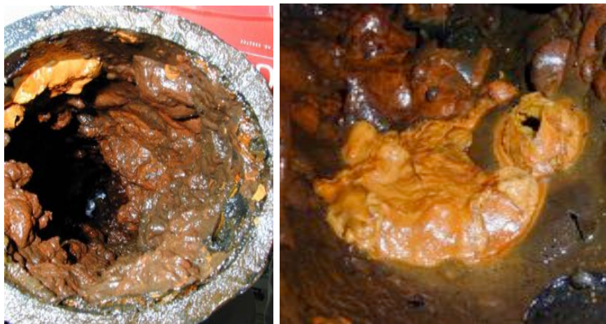
Abb.4: Innenansicht eines Trinkwasserrohrs. Mit freundlicher Genehmigung von Prof. Flemming IWW Mühlheim Ruhr Universität 2012.
